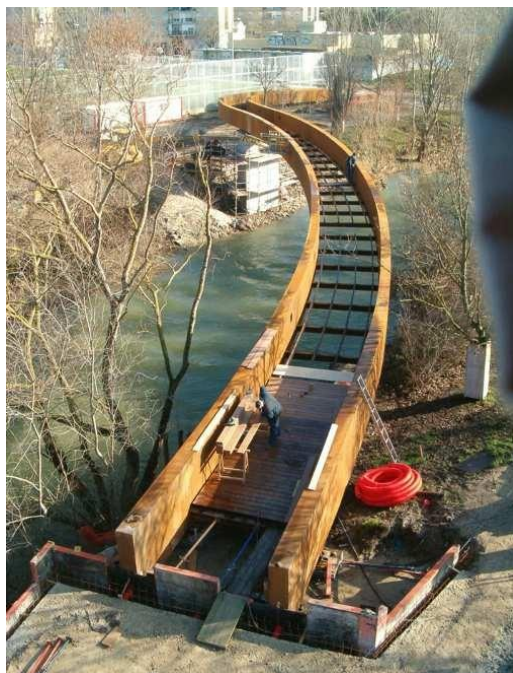
Figura 18. Construcción de la pasarela de San Jorge. Años 2008-2009. Subvencionado por la Unión Europea mediante fondos de cohesión (80%). Fuente: Ayuntamiento de Pamplona
